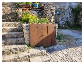
Exemples – compteur électrique
