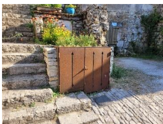
Exemples – compteur électrique
